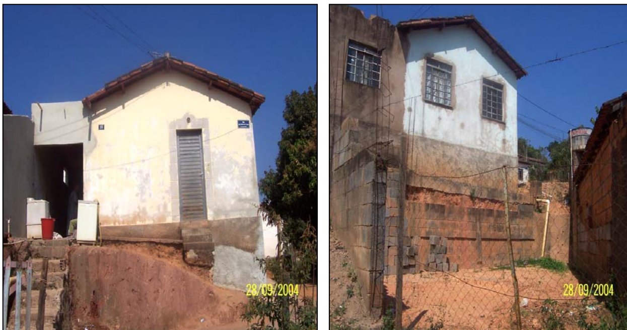
Figura 3– Fotos de casas do loteamento Alto do Gaia – baixo padrão e algumas já com rachaduras
